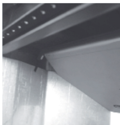
Fig. 15: elevador do defletor de chama
